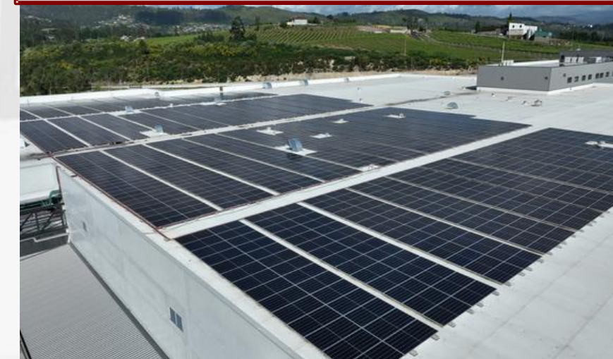
Hijos de Carlos Albo 1 MW/1.1k modules 2023
