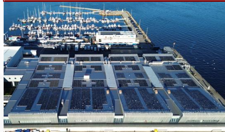
Lonxa de Ribeira 527KW/1k modules 2023
