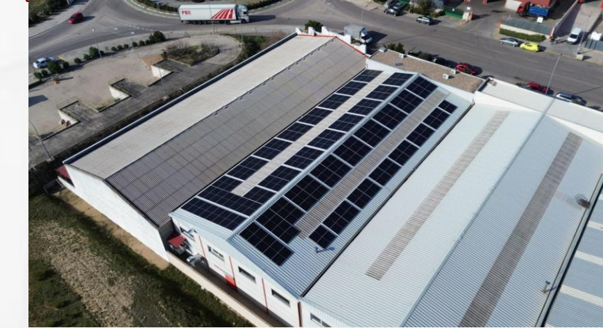
Adistafarma 102,06 KWp /189 modules 2023
