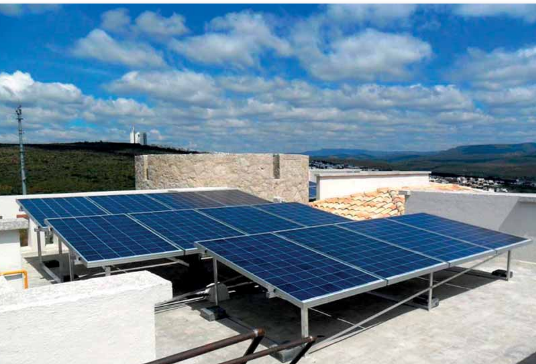
Instalación residencial en León, Guanajuato, México, de Desmex Solar.
